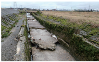
金山新、田尻地区の農業用施設の破損
