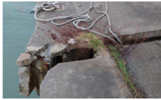
水橋漁港の物揚げ場の亀裂
