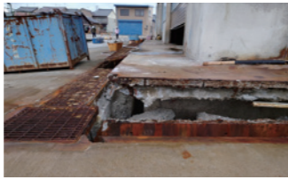
水橋漁港の荷さばき施設周辺の陥没
