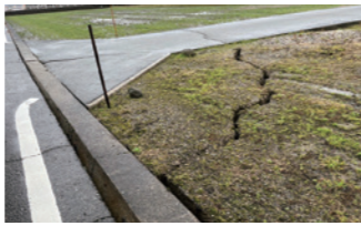
道路・周辺地盤の亀裂
