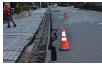
富山市役所南側道路の亀裂と噴砂跡
