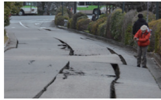
富山県庁 南側道路 変状状態
